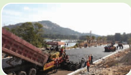
峡谷旅游路建设又到新节点! 10月31日起,峡谷旅游路进入底层沥青铺设,11月底整条主路面的底层沥青即可铺设到位。(记者康清辉 颜华杰)
