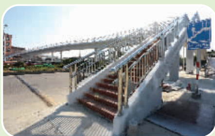
日前,架设于石狮大道上的城北人行天桥已具备通行条件,工程已基本完工。不时有附近的市民通过天桥往返石狮大道两侧。(记者林智杰 颜华杰)
