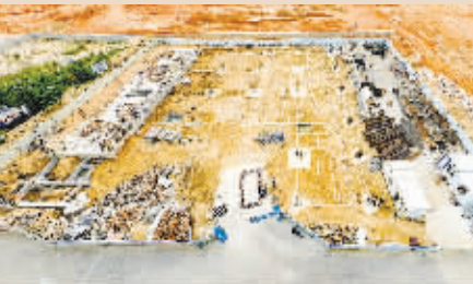
作为石狮重点项目之一的石狮战地吉普厂房建设项目,正如火如荼建设中。日前,记者来到项目建设现场,了解到该项目桩基施工已接近尾声,雏形初见。(记者王文豪 李荣鑫)
