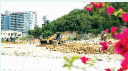
石狮市总医院公交首末站项目建设加速推进中,预计在9月份即可建成。建成后,将为逐步实现从总医院首发的公交线路覆盖沿海各镇打下基础,方便群众公交出行就医。(记者 康清辉 颜华杰)
