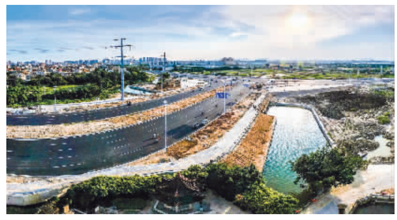
下半年启幕不久,一重环湾快速路石狮接线工程随即有好消息传来:这条“T”字形主路已经铺完面层沥青,路灯和交通标线也同步到位。城投集团交建公司相关负责人介绍,目前辅道、人行道以及护坡也在加速收尾,整个项目的道路工程部分8月初即可全部完工。(记者 康清辉 李荣鑫)
