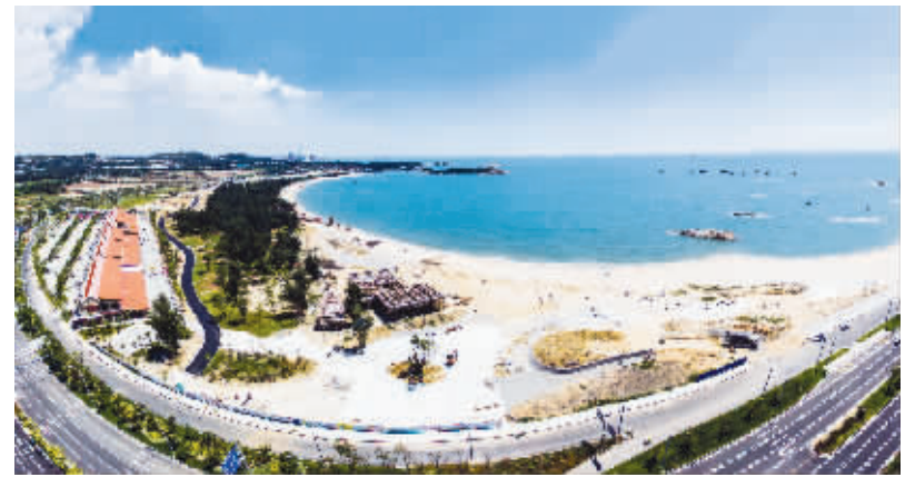
记者近日在红塔湾海岸公园施工现场看到,红塔湾海岸公园整体雏形已经显露。预计到年底,公园的主体形象即可较好呈现给市民游客。尽管如今还是雏形,但从记者的航拍图来看,天蓝、海绿、沙黄,再搭配大排档的红屋顶、木麻黄和草皮的翠绿,丰富的元素组合下,这个美丽的“月牙形”海湾景区已然令人无限沉醉。 (记者 康清辉 李荣鑫)
