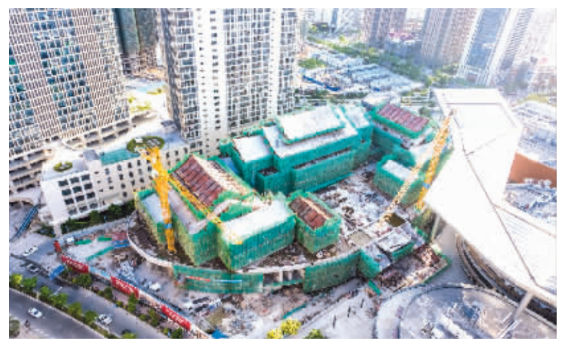
日前,记者在石狮世茂故宫海上丝绸之路馆施工现场看到,该项目主体工程已经完成封顶,目前项目正在进行地下室施工以及建筑砌体工作,预计2020年6月建成开放。 (记者 王文豪 李荣鑫)
