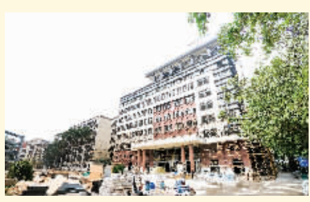
近日,记者获悉,石狮市中医院建设项目已累计完成工程量的65%,完成投资额3500多万元。目前,医技楼的外墙架也已拆除,正在进行内部诊室的装修工作。 (记者 高荣芳 李荣鑫)
