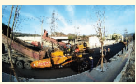
1月7日,拥军路改造提升段正式摊铺底层沥青。自此,从学府路口开始至共富路郭宅村段,整条拥军路实现了全线贯通。 (记者 康清辉 颜华杰)
