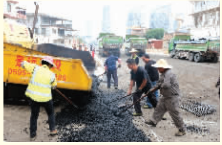
近日，九二东路(濠江路—回兴路)完成底层沥青摊铺，两侧人行道铺装、路灯安装和行道树绿化等工序陆续跟进，将力争在4月底完成。(记者 康清辉 李荣鑫)
